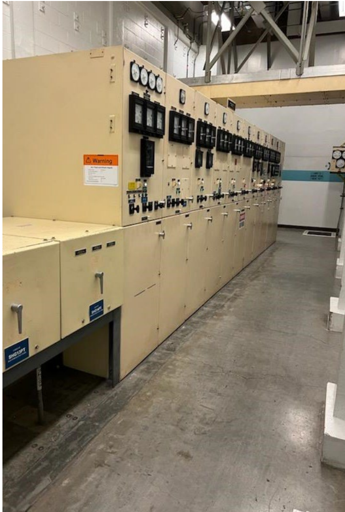
4kV Vital Bus 2H
